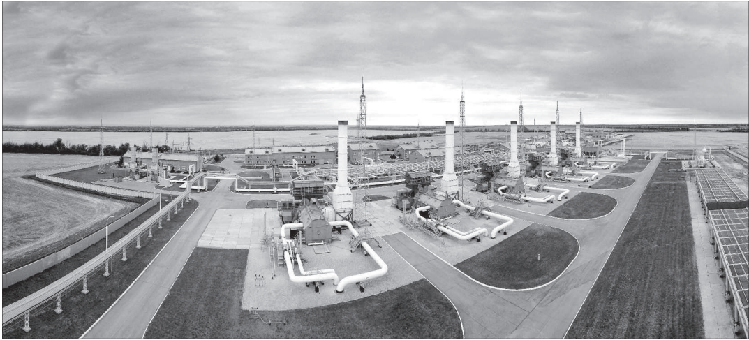
● Современные газоперекачивающие агрегаты обеспечивают бесперебойную поставку голубого топлива потребителям.
