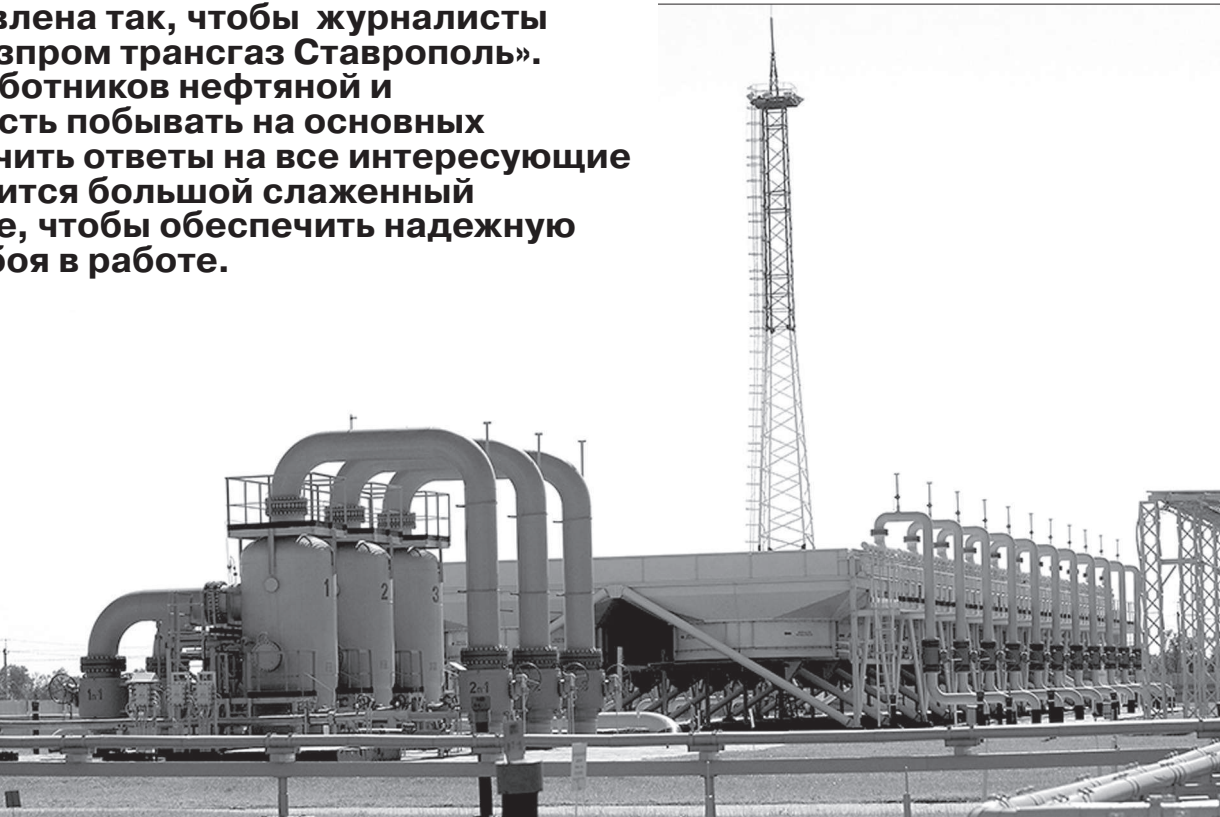
● На компрессорной станции.
