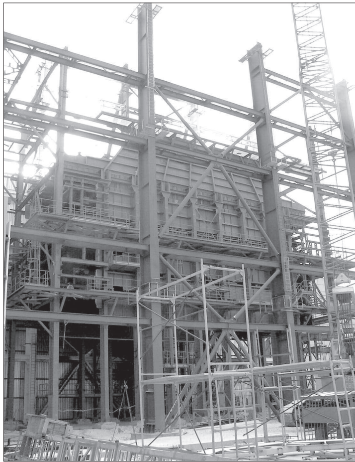
● Котел-утилизатор строящейся ПГУ-410.
